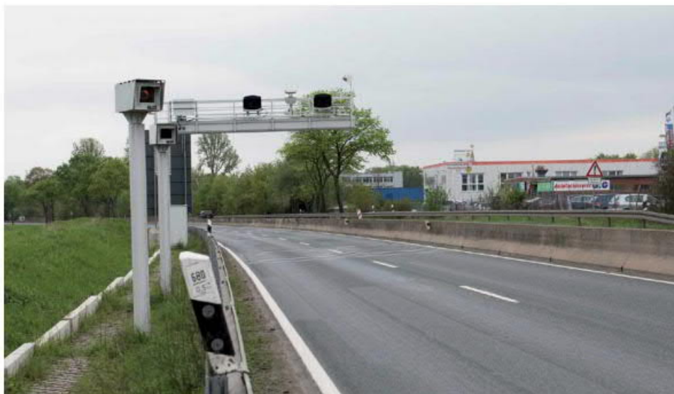
Bild 3: Blick auf das Ausfahrtsportal der Pilotanlage. Man erkennt den Kragarm, der Laserscanner und Spurkameras trägt. Am linken Bildrand sind das Blitzlicht und die Kamera für das Heckfoto zu sehen, das von Schnellfahrern erstellt wird. Außerhalb des Bildausschnitts stehen Kameras und Blitzlicht für das Frontfoto.
